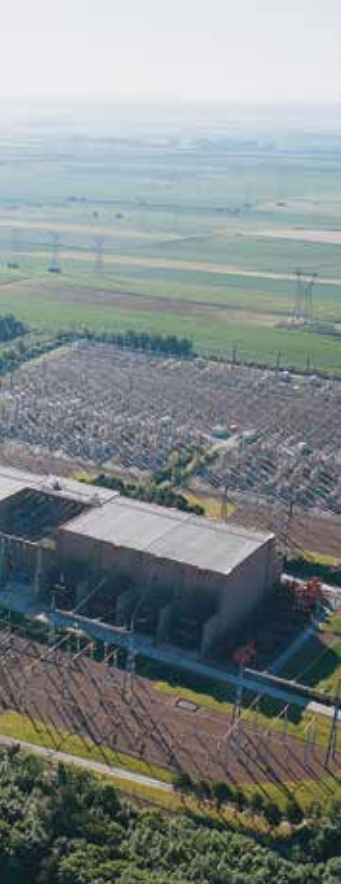
Estración conversora de Pas de Calais (Francia) de la interconexión Francia-Inglaterra. / Laurent Weyl / RTE
