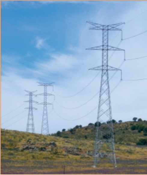
Apoyos del primer circuito de la línea de interconexión Balboa-Alqueva
