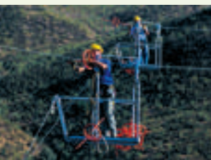
Señalización de líneas con espirales «salvapájaros»
