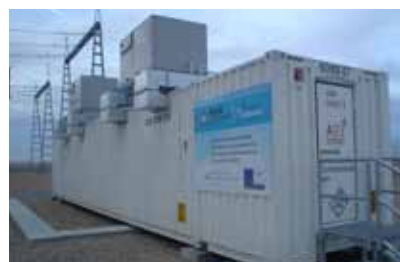
Batería de ión-litio instalada en la subestación de transporte de Carmona (Sevilla).
