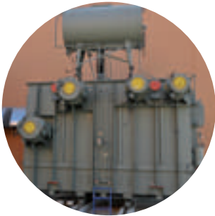
Detalls d'equips de les estacions conversores
