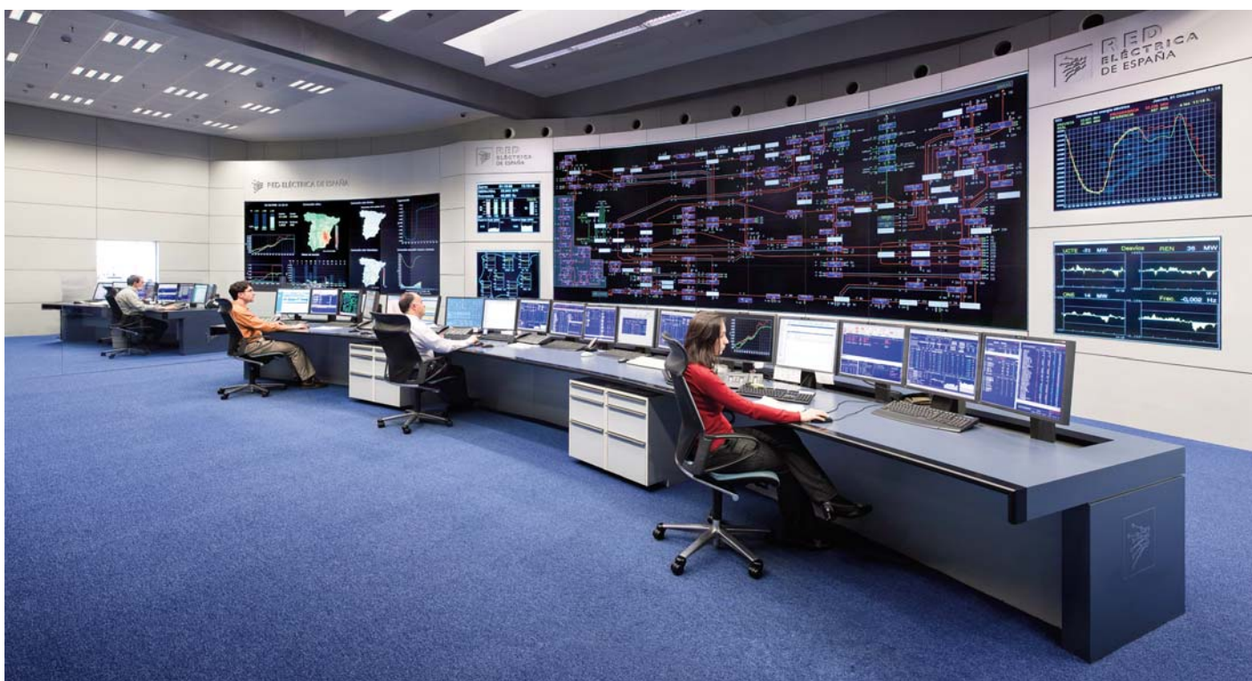
Sala de control eléctrico del Cecoel, con el centro de control de renovables, Cecre, al fondo.
