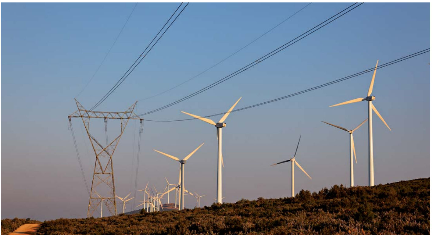
Línea de alta tensión para la evacuación de energía eólica.
