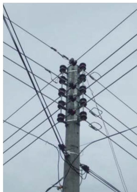
Línea eléctrica de distribución.
