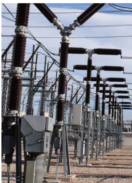
Subestación de transformación.
