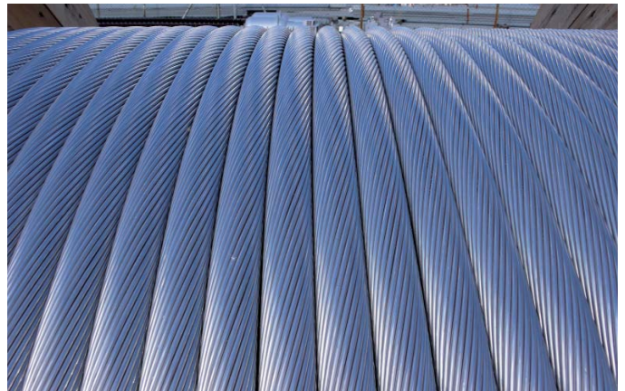
Detalle de cable de alta tensión.
