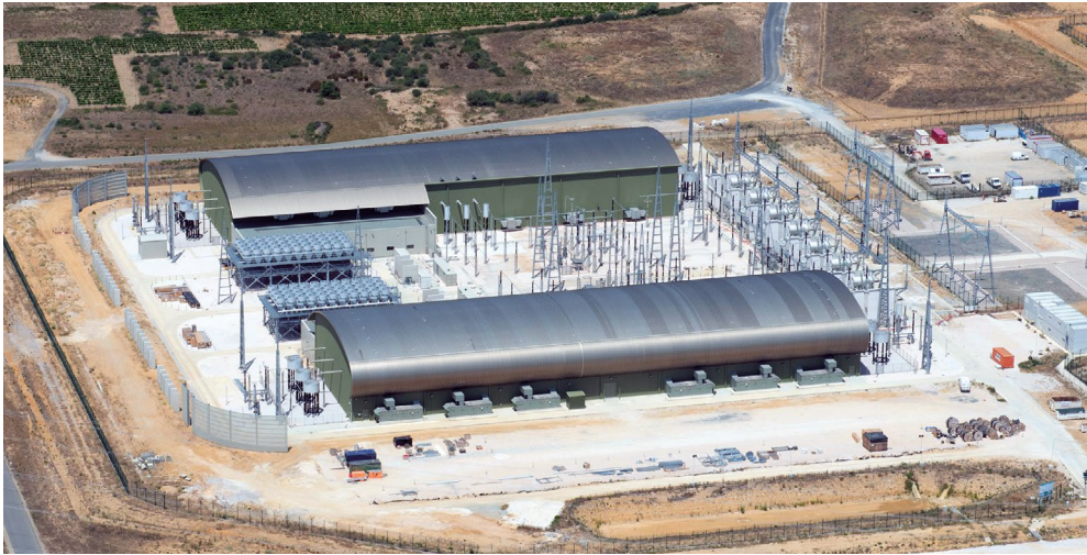
Transformazio-estazioa (Baixas, Frantzia)
