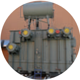
Detalles de equipos de las estaciones conversoras
